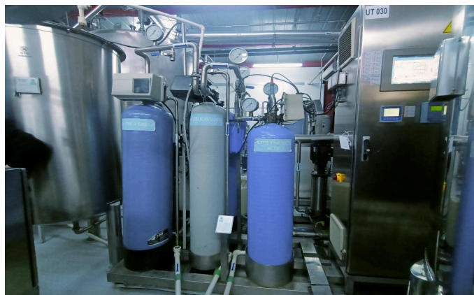
Figure 24 : Installation du pré-traitement dans la station d'eau purifiée chez LDM.
