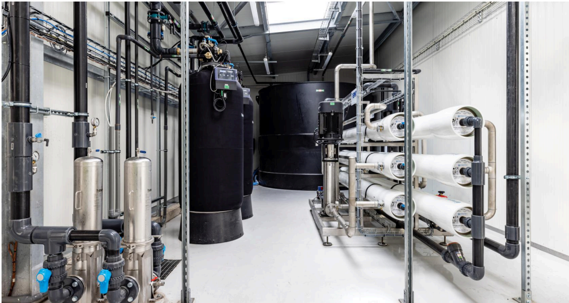
Figure 4 : Station de production d'eau purifiée[26].
