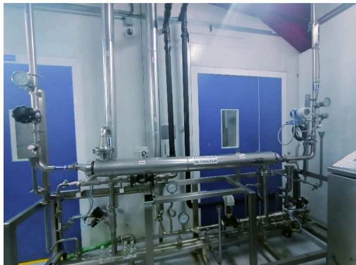
Figure 23 : Échangeur de chaleur.
