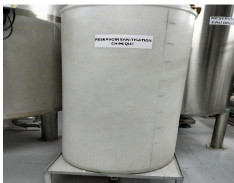
Figure 26 : Réservoir sanitisation chimique.
